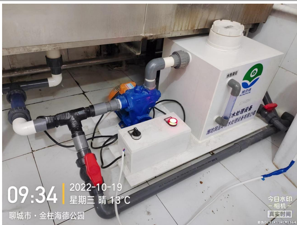
污水处理设备
