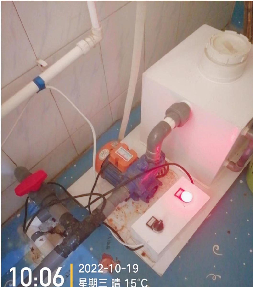
污水处理设备
