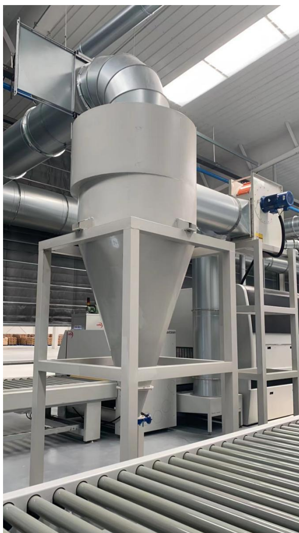
涂装工序旋风除尘器
