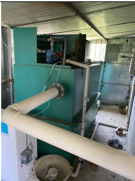
废水处理设施
