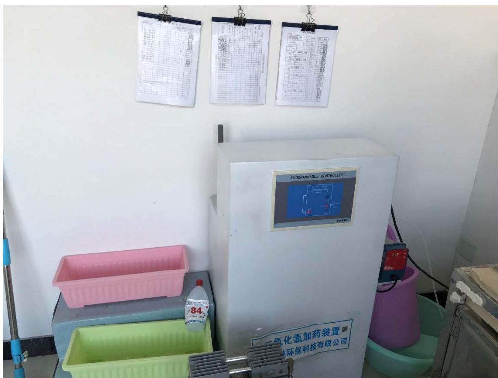
图 3-1 项目污水处理设施图
