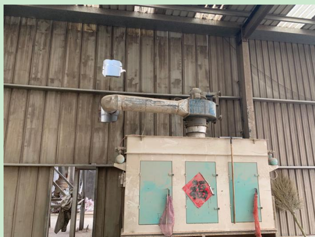
投料粉尘布袋除尘器
