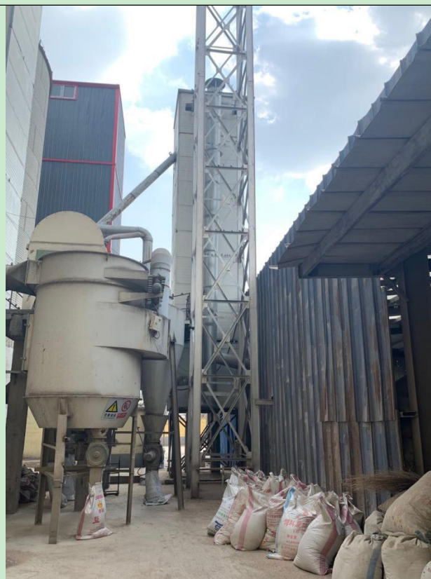
15m 高排气筒
