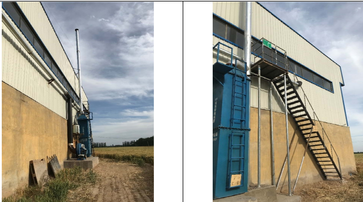
SCR 废气处理设备、采样平台、排气筒
