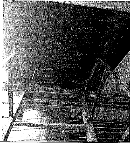
P3 喷塑工序排气筒监测孔+采样平台
