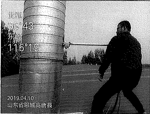
光氧固化排气筒 P4 (出口)
