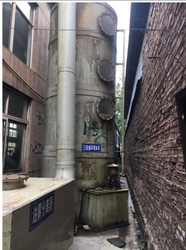
三级循环喷淋塔+油雾分离器
