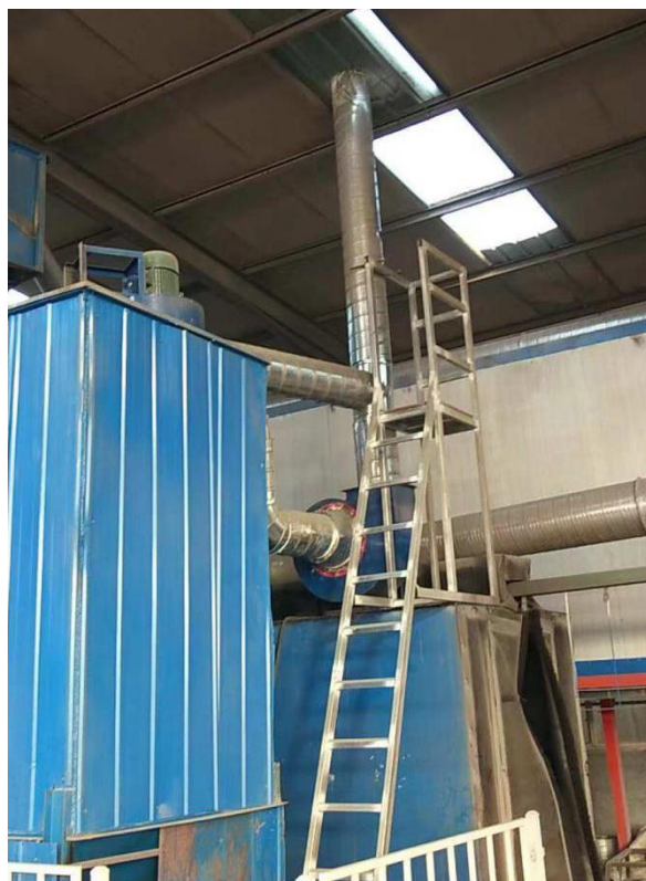
布袋除尘器排气筒
