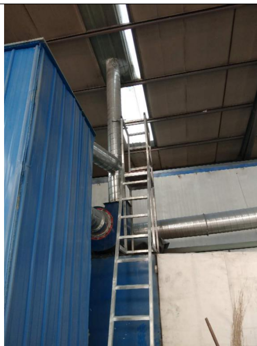
废气排放标识整改前
